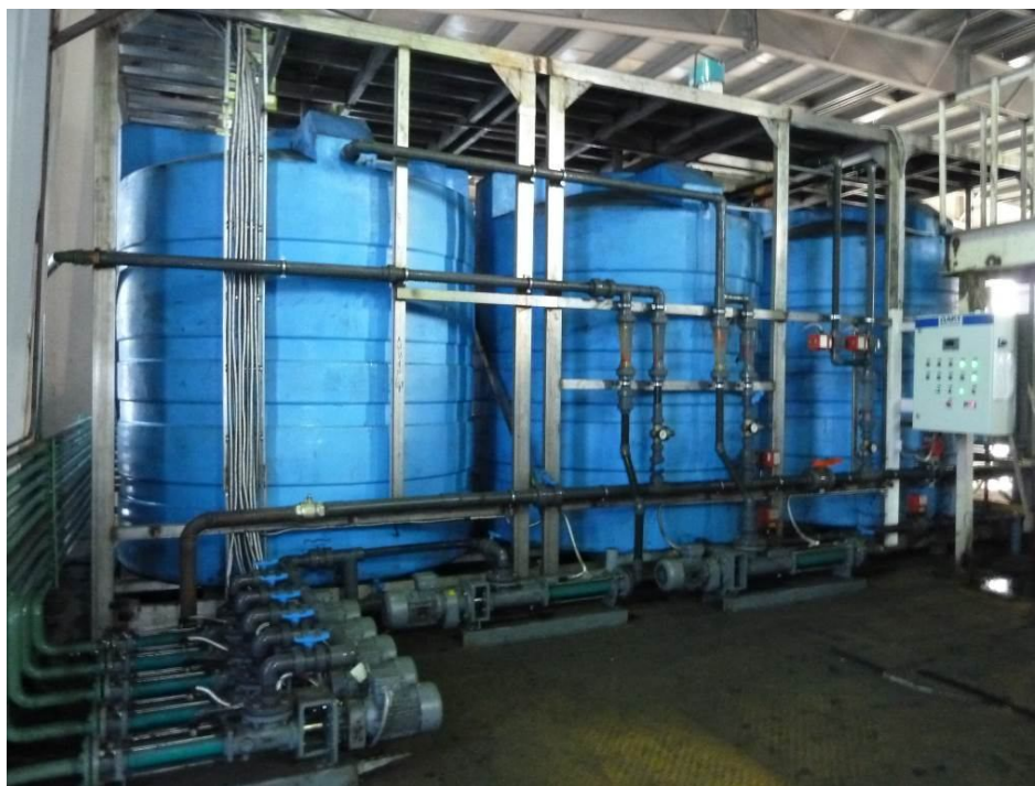
Станция приготовления флокулянта
